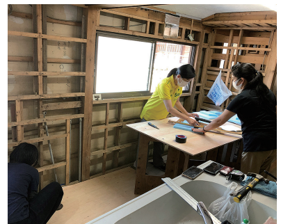
熊本県八代市坂本で水害にあった住宅の復興のためのワークショップ。これも依頼先が難しい仕事だ
