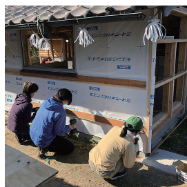
コミュニティ大工の指導のもと外壁を施工する建て主と友人
